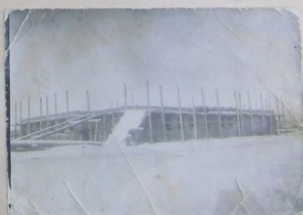
Строительство средней школы 1929г. Здесь была окраина села, а дальше начинались поля.
